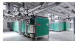
Aplicaciones HVAC e Iluminación
